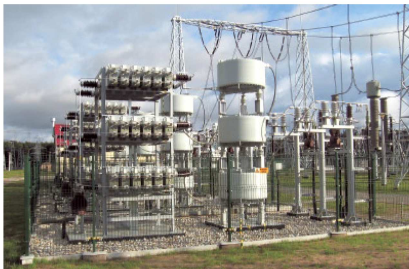
Rys. 3. Bateria kondensatorowa 60 Mvar/15 kV, z szeregowym dławikiem odstrajającym
