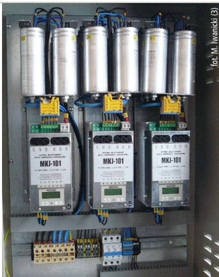
Fot. 3. Bateria kondensatorów z modułami jednofazowymi
