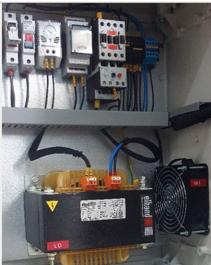
Fot. 1. Statyczna bateria dławików BDI
