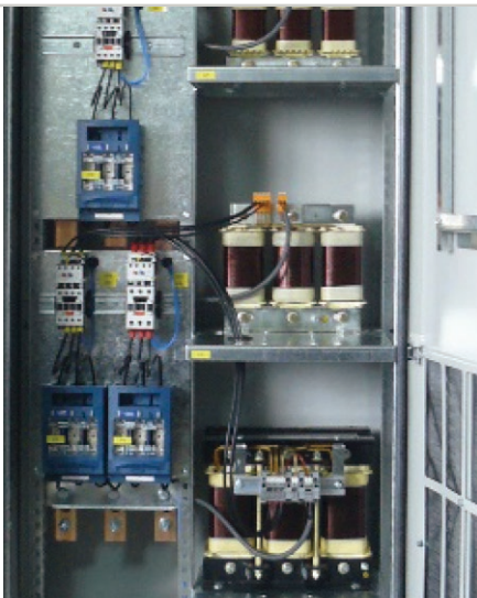
Fot. 2. Automatyczna bateria dławików typu BDA
