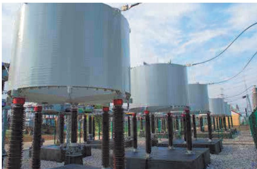
Fot. 2. Widok stanowiska dławików kompensacyjny bezrdzeniowych 110 kV.
