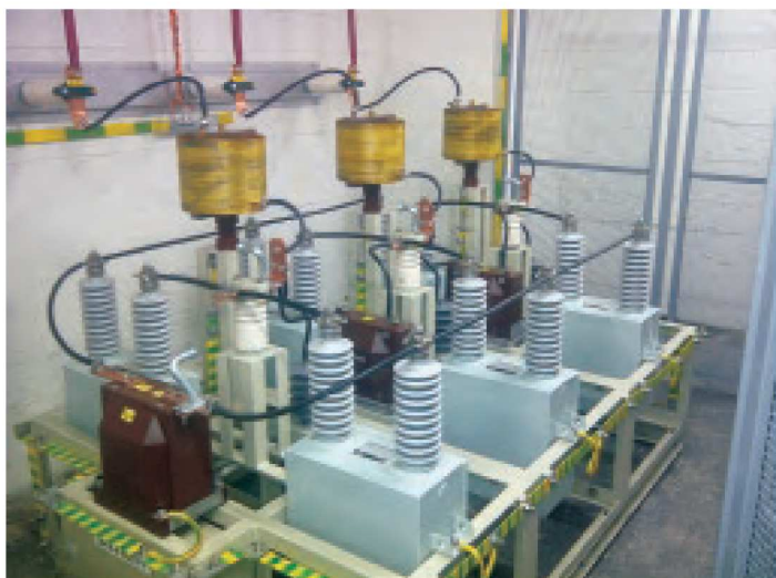
Rys. 5. Widok baterii kondensatorów BKS-6 z dławikami ograniczającymi prądy łączeniowe
