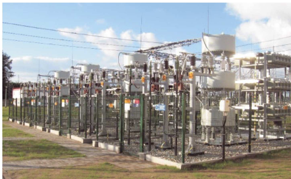
Rys. 2. Widok stanowiska baterii kondensatorów
