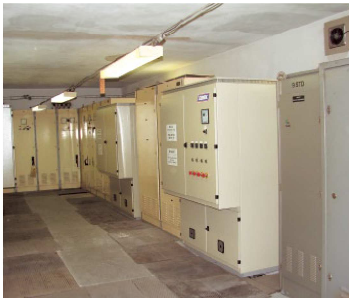
Rozdzielnia 0,4 kV, w której zainstalowano baterie dławików 2×BDA 280/20 kvar
