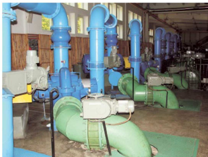
Stacja pomp Zemborzycza
