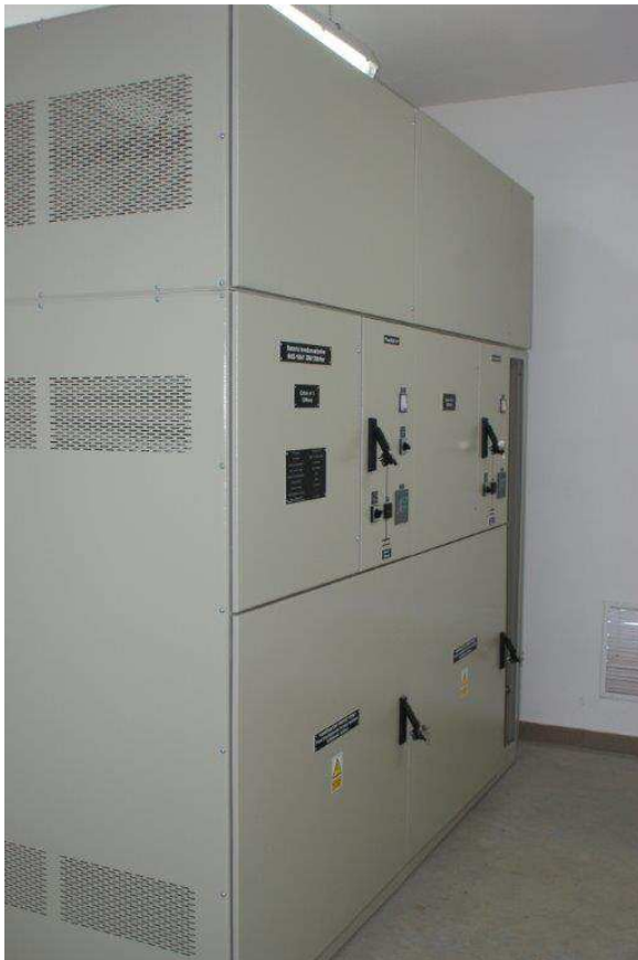
Bateria BKS U_n=10kV , Q=900kVar , człony 300kVar i 600kVar , wyposażona w dławiki ograniczające prądy łączeniowe, wkładki bezpiecznikowe SN i ograniczniki przepięć.
