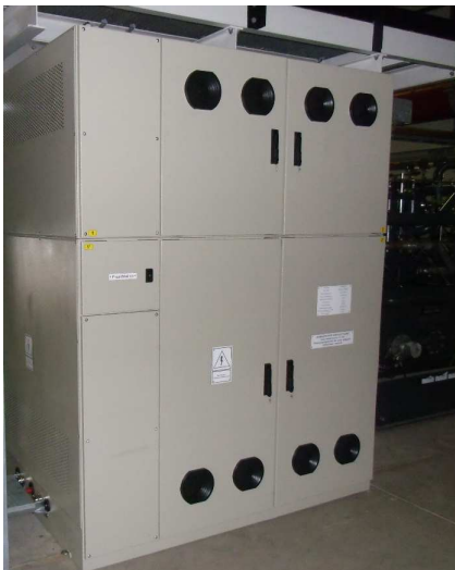
Bateria kondensatorów BKW U_n=10kV , Q=1100kVar , wyposażona w dławiki ograniczające prądy łączeniowe i ograniczniki przepięć.
