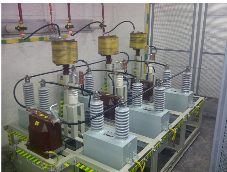
Fot 1. Widok baterii kondensatorów BKS-6 z dławikami ograniczającymi prądy łączeniowe
