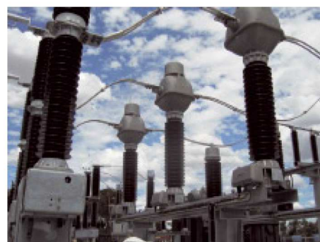
Przekładniki wysokiego napięcia w izolacji olejowej
