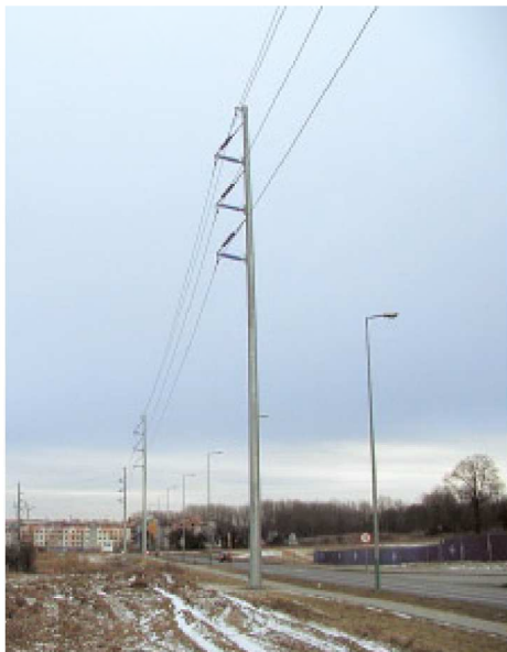
Linie napowietrzne wysokiego napięcia na bazie słupów rurowych
